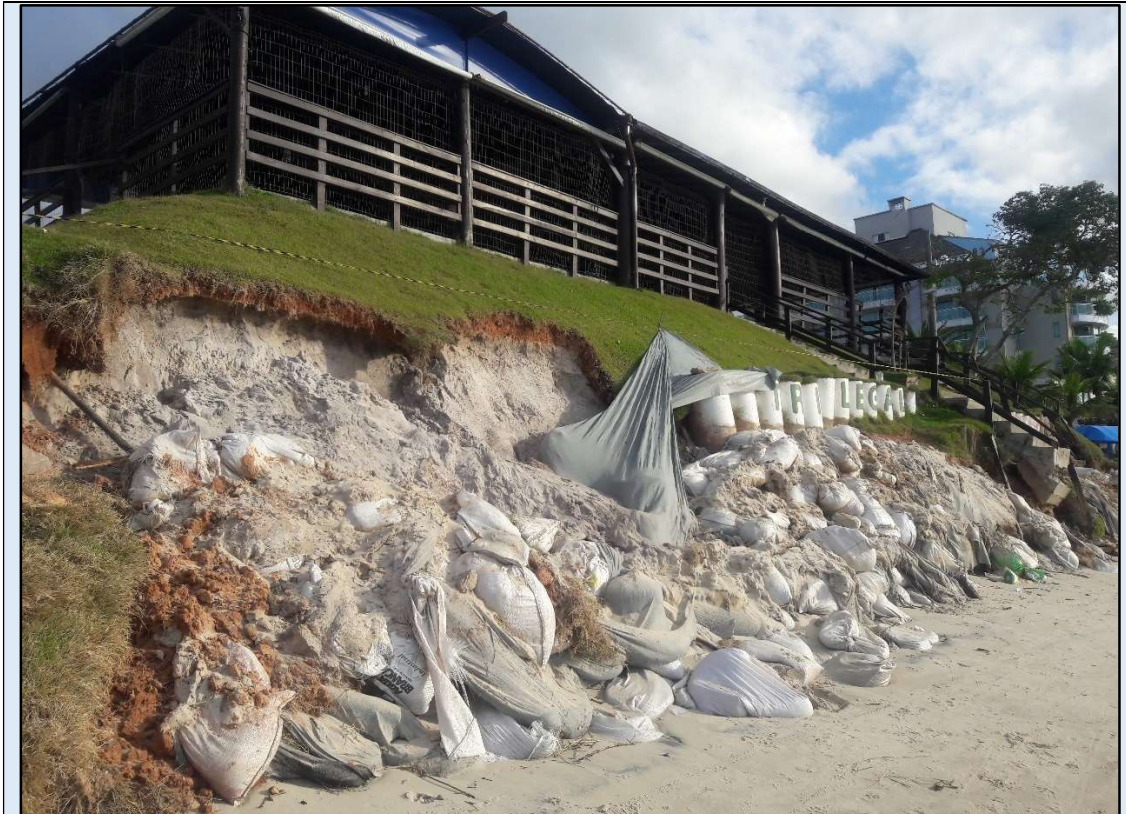
Figura 63. Falésia pronunciada na praia de Canasvieiras, ilha de Santa Catarina, resultado de processo erosivo em maio de 2017.
